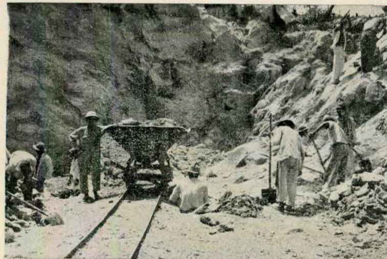
6 — Interior da cava principal da exploração de amianto em Bom Jesus de Poções, Baía.
